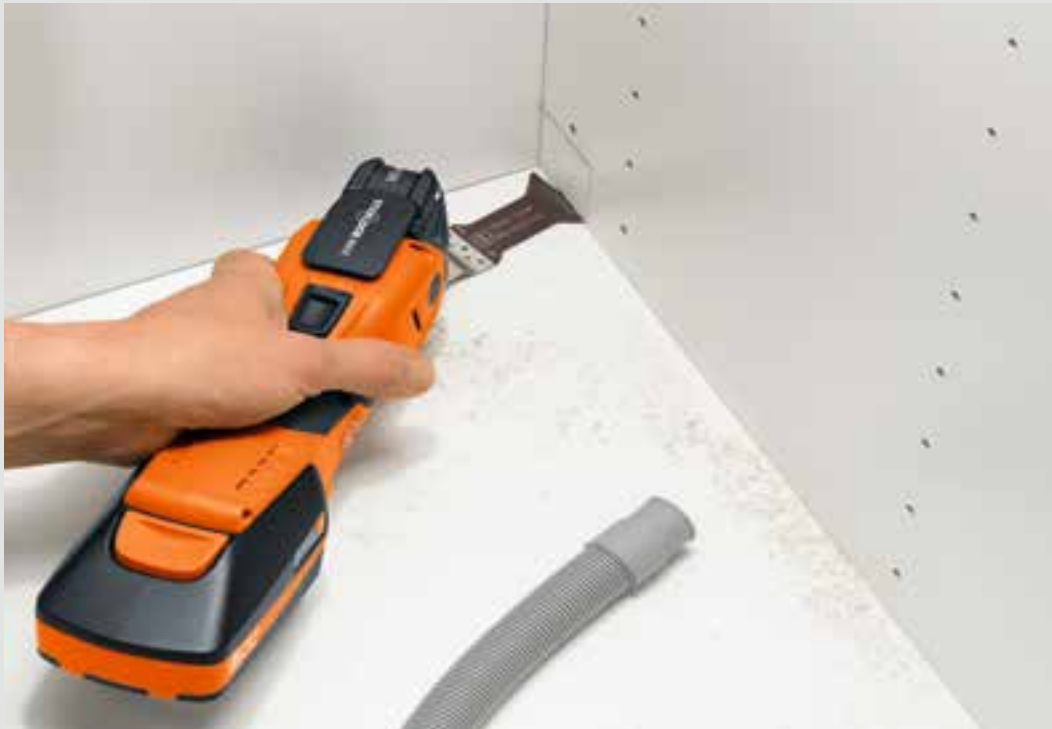
Aussparungen an Möbeln an schwer zugänglichen Stellen.
